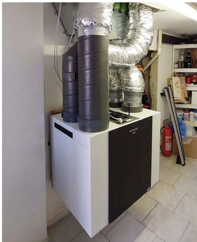
Instalovaná jednotka VENTBOX 400 v technické místnosti
